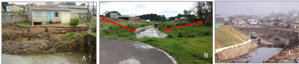
Figura 2 – Imagens fotográficas (A) Residência localizada em área de risco na margem do rio Ressaca; (B) Rio Ressaca executado em canal aberto, localizado no trecho 2 com a faixa de manutenção de 8 m; (C) Desassoreamento e retirada de sedimentos do leito do rio Ressaca em trecho executado em canal aberto.
